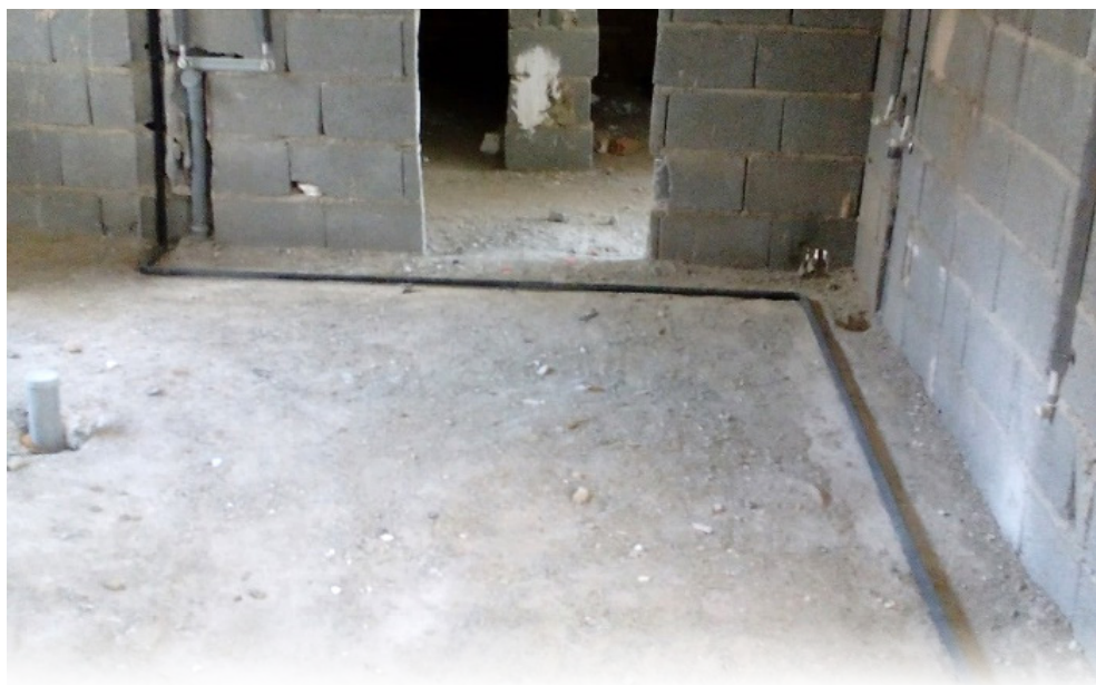
رعایت دورترین فاصله لوله گاز از کفشور و فاصله مناسب آن از دیوارها
