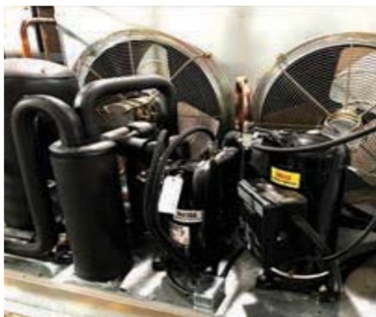
پمپ حرارتی سردخانه
